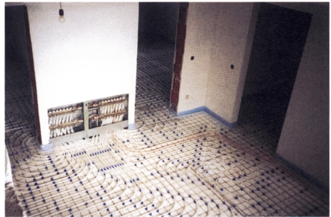
Heizkreisverteiler: FBH mit 10 cm Verlegeabstand
